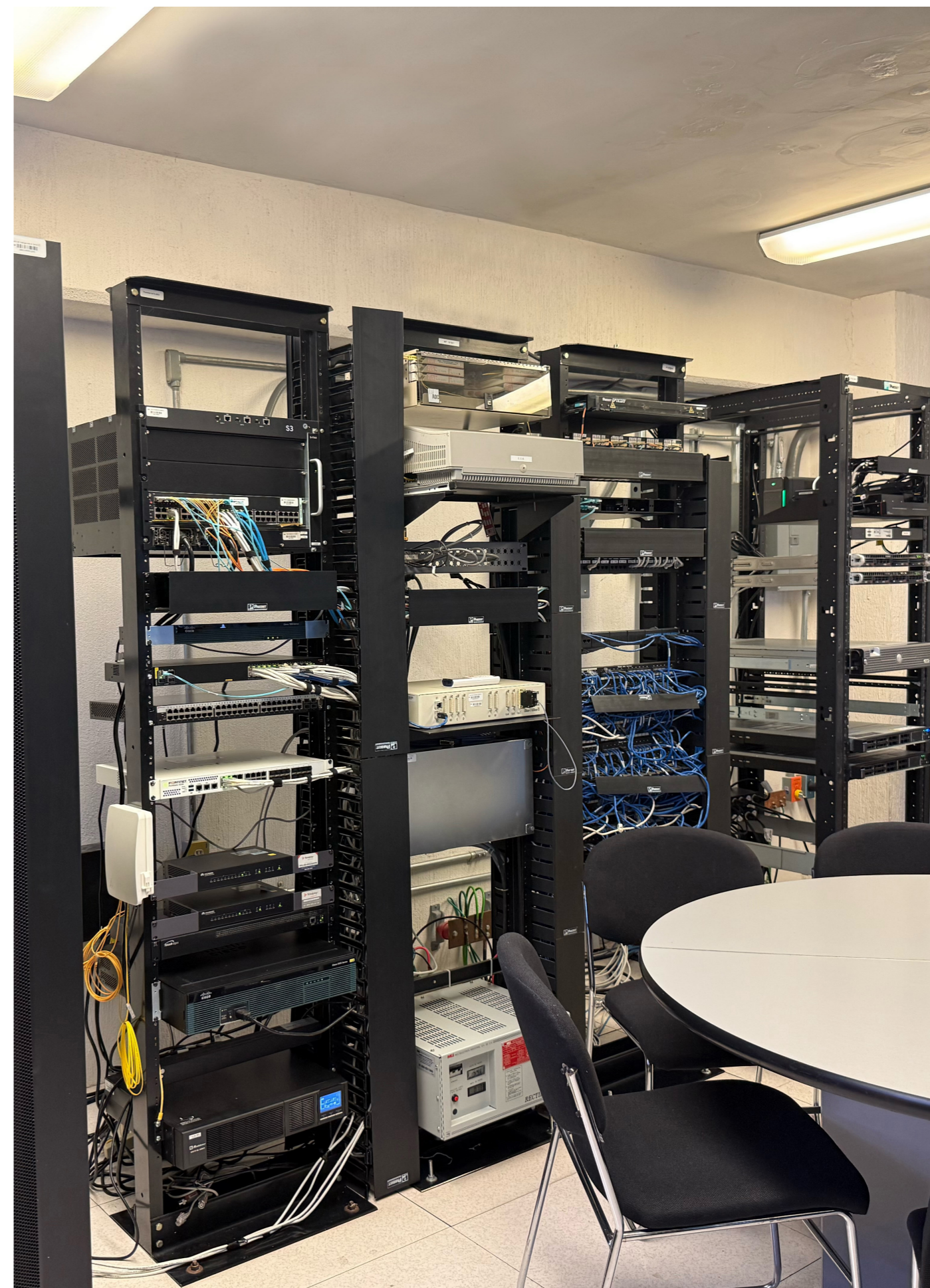
Site de comunicaciones: Centro de control de la red (backbone), enlace a Internet (routers), troncales telefónicas, conmutador y servidores de alto desempeño.
